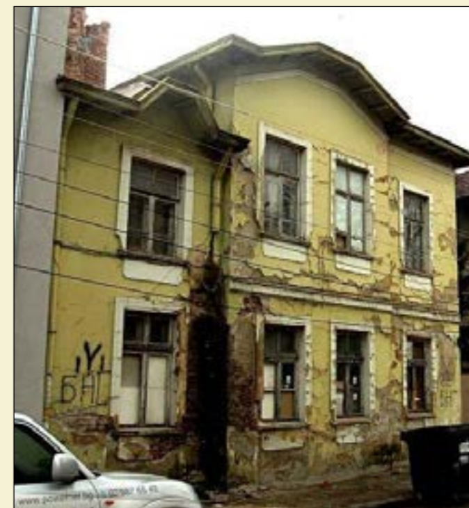
Къщата на поета – разрушена
